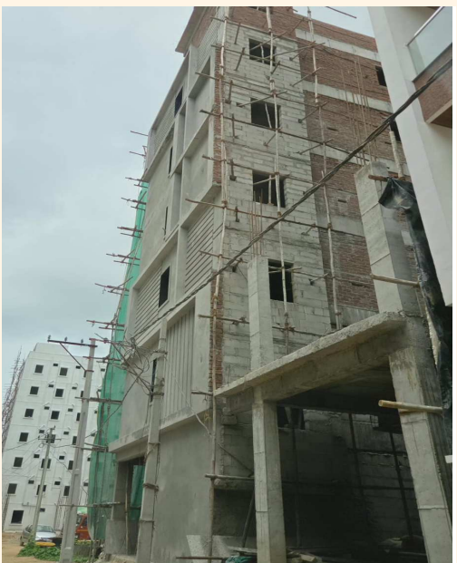
మియాపూర్, లక్ష్మీ రెస్టారెంట్ వెనుక అనుమతికి మించి భారీ నిర్మాణం.
